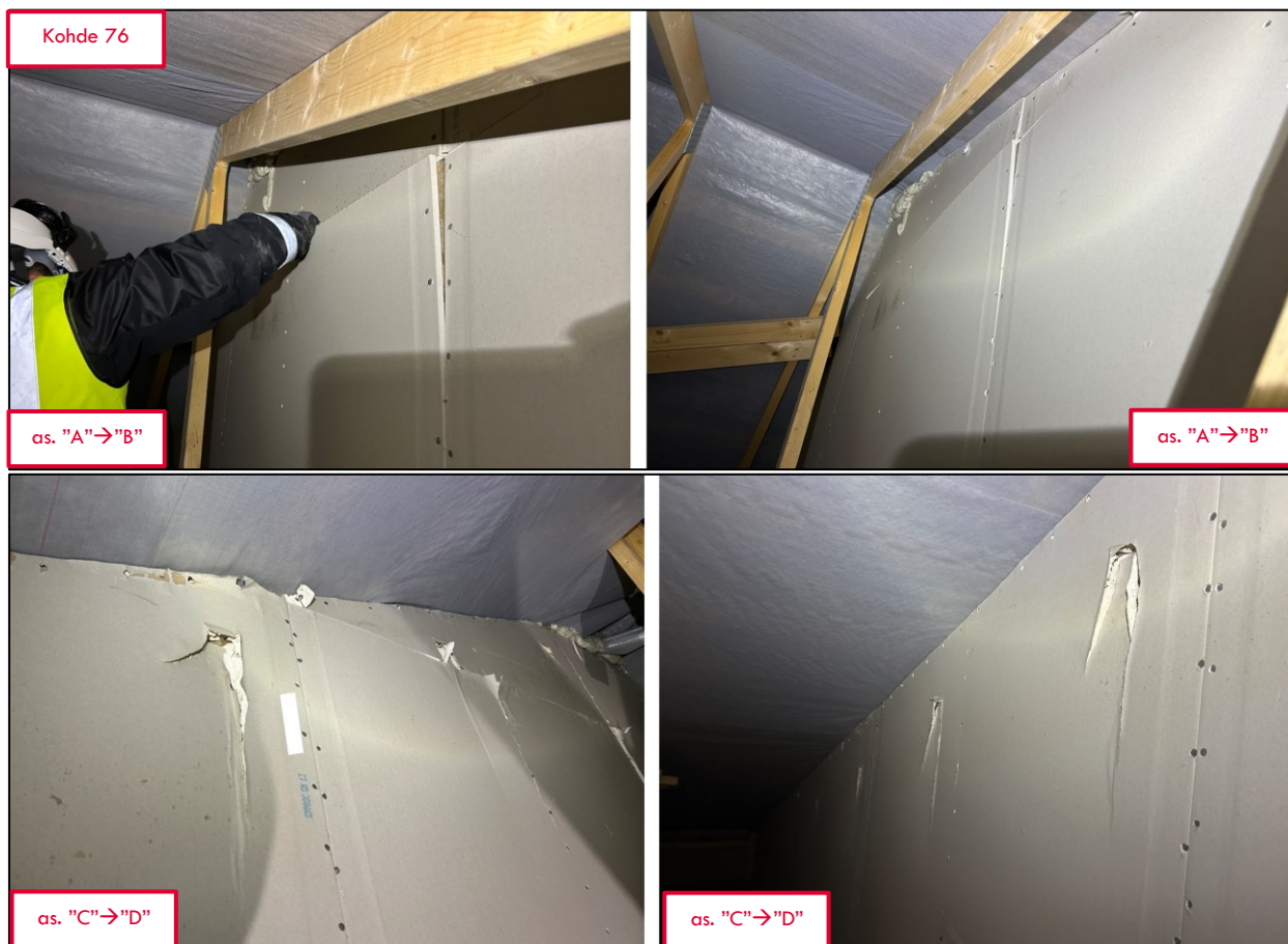
Kuva 74. Paikalla rakennettu ullakon HVS. Levytyksen asennuksessa epätarkkuutta. Osa levysaumoista irvistää. Levyn vaakasaumassa ei havaita kiinnittimiä. Levytyksessä havaittiin säännöllisiä murtumajälkiä (C→D). Rv=2017. Valokuvat: J-P Laakso / SPPL
