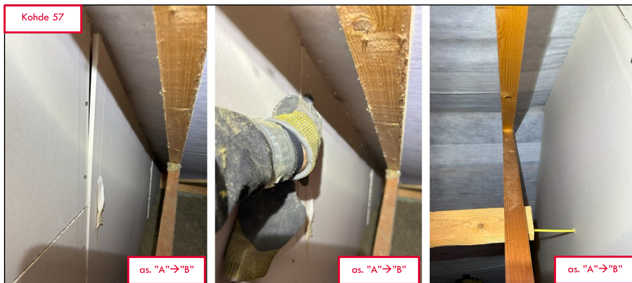
Kuva 76. Paikalla rakennettu ullakon HVS. Yläpaarteen kiinnittäminen käytännössä hankala, koska ristikko lähellä HVS:ä. Levy liikkuu sormella painamalla. Rv=2017. Valokuvat: J-P Laakso / SPPL
