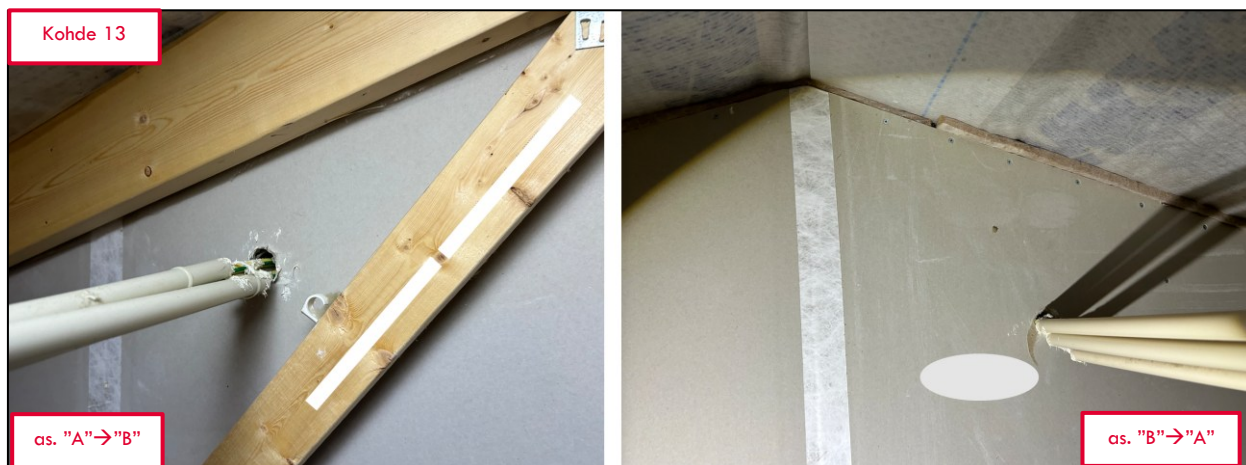
Kuva 78. Maadoitusjohtimet kuvattuna HVS:n molemmin puolin. Liitosta ei ole tiivistetty. Rv=2020. Valokuvat: J-P Laakso / SPPL.
