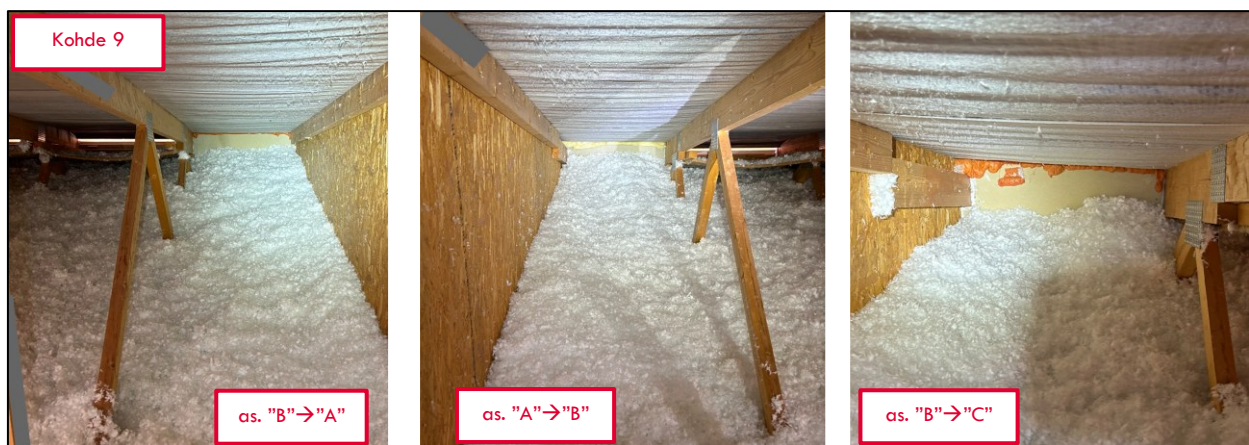
Kuva 88. PU-tiivistysvaahdolla tiivistetty P-O:n levitystä ulkoseinällä. Toteutuksessa havaittiin vaihtelua. Keskimmäisessä kuvassa (as. A→B) levitys havaittiin tiivistetyksi mineraalivillalla ja as. B→A vastaavasti PU-vaahdolla. Rakenneleikkauksessa ei ollut mainintaa vaahdon käytöstä. Tiivistysvaahdon tuotemerkki ei selvinnyt käynnillä. HVS on poikkeuksellisesti toteutettu OSB levyillä. Tämä toteutus edellyttää rakennesuunnittelijan tekemää palomitoitusta. Yläpohjan HVS:n toteutuksessa yleisin levymateriaali on aineiston perusteella A2-luokan kipsilevy kuten tässäkin kohteessa US:n levityksen toteutuksessa. Rv=2022. Valokuvat: J-P Laakso / SPPL.
