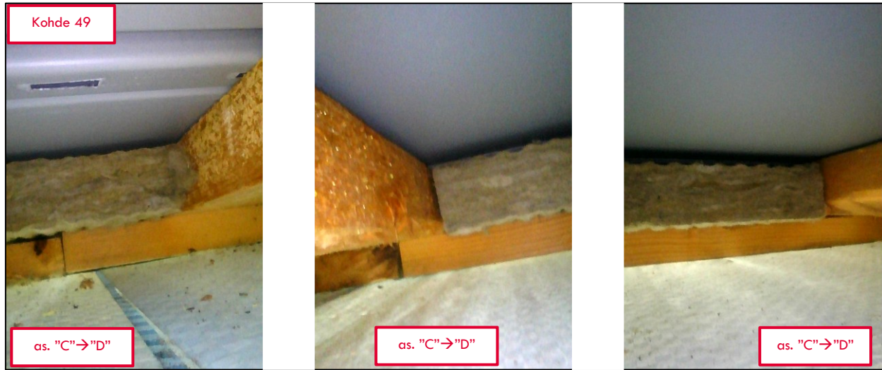
Kuva 39. Peltikatteellisen rakennuksen HVS:n ja VK:n liitos. Rv=2018. Valokuvat: J-P Laakso / SPPL.
