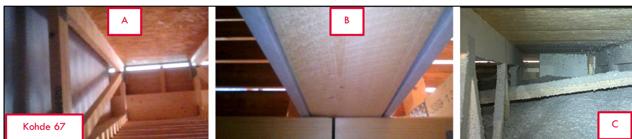
Kuva 63. Terassin LP-palkin kohdalla havaitaan TVS:n päädyn ja julkisivun välissä rako, josta palokaasut pääsevät kiertämään palo-osastosta toiseen. Terassin katto on harvalaudoitettu. Rakennesuunnitelmassa oli suunniteltu myös terassin ja julkisivun liittymään palo-osastoinnin levitys, kuten lämpörajalla kuvassa C. Rv=2022. Valokuvat: J-P Laakso / SPPL.
