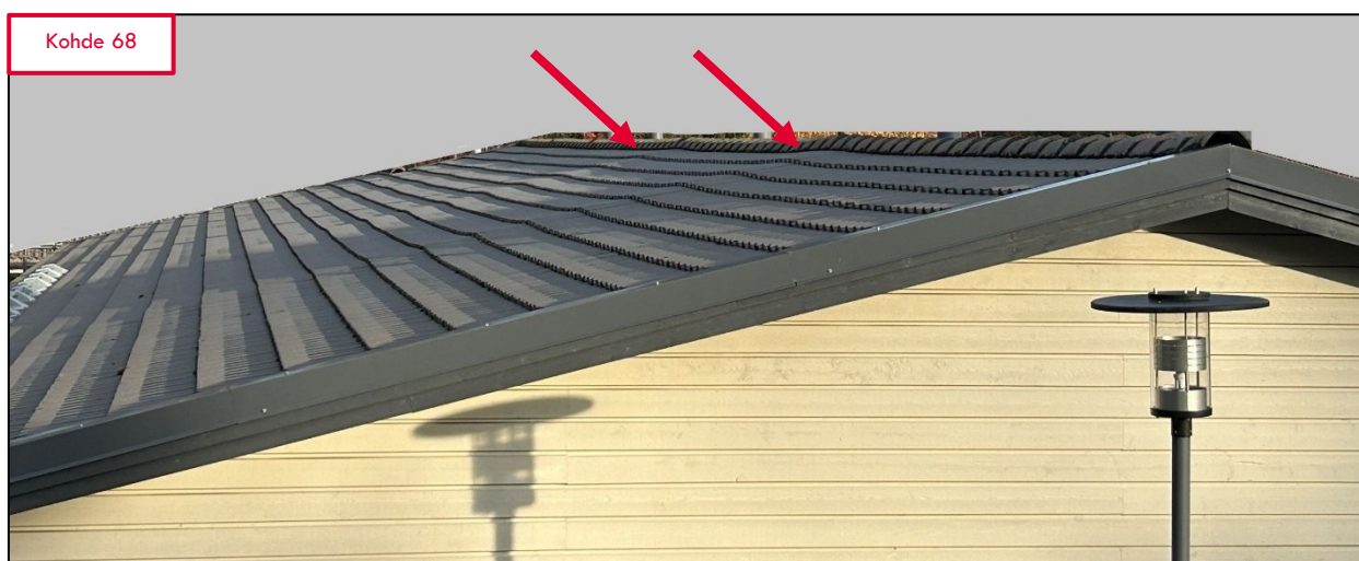
Kuva 53. Kattolape, jossa ristikkokentän painumat havaittavissa. Syysaurinko paljastaa lappeen aaltoilun. Vastaavaa aaltoilua ei esiinny ristikon tuella eli ulkoseinällä. Valokuvat: J-P Laakso / SPPL.
