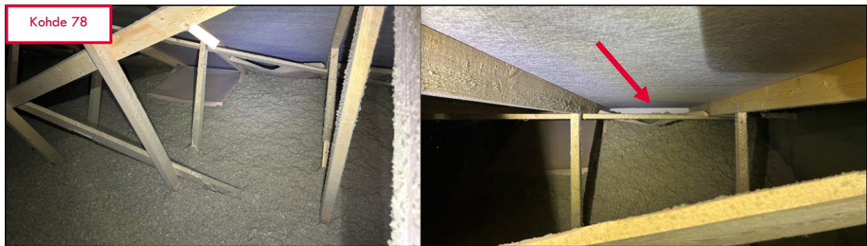
Kuva 98. Tuuliohjaimet asennettu myös palo-osastoinnin levityksen kohdalle, jossa tuuletusrako tukittu (nuoli). Nitoja kiinnityksestä irronnut tuuliohjain vasemmalla. Palo-osastoinnin levitys havaitaan kuvassa oikealla. Rv=2019. Valokuvat: J-P Laakso / SPPL.
