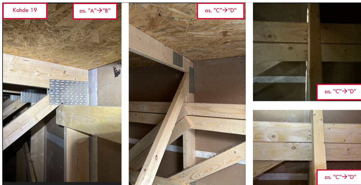
Kuva 18. Ristikkoa vasten kohtisuoraan toteutettu palo-osastointi, jossa ristikko katkaistu HVS:n kohdalla ("as. A→B") ja ristikko läpäisee HVS:n ("as. C→D"). Levytyksen ja ristikon kannan välistä loistaa valo läpi. Rv=2022. Valokuvat: J-P Laakso / SPPL.
