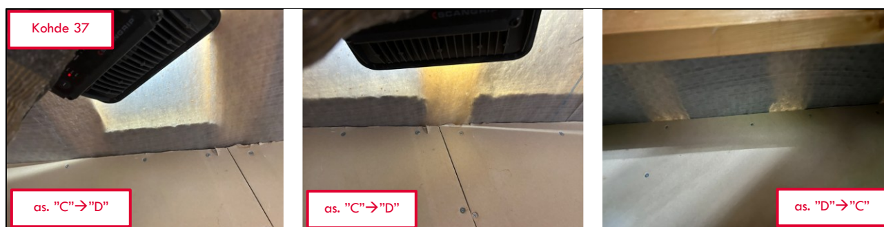
Kuva 42. Jatkoa edellisen kuvan kohteesta. HVS:n ja VK:n liitos asuntojen välillä. Ruuteiden välissä olevaa epäjatkuvuuskohta havainnollistettu valolla. Valo loistaa ruuteen ja HVS:n välistä seinän "yli". Rv=2018. Valokuvat: J-P Laakso / SPPL.
