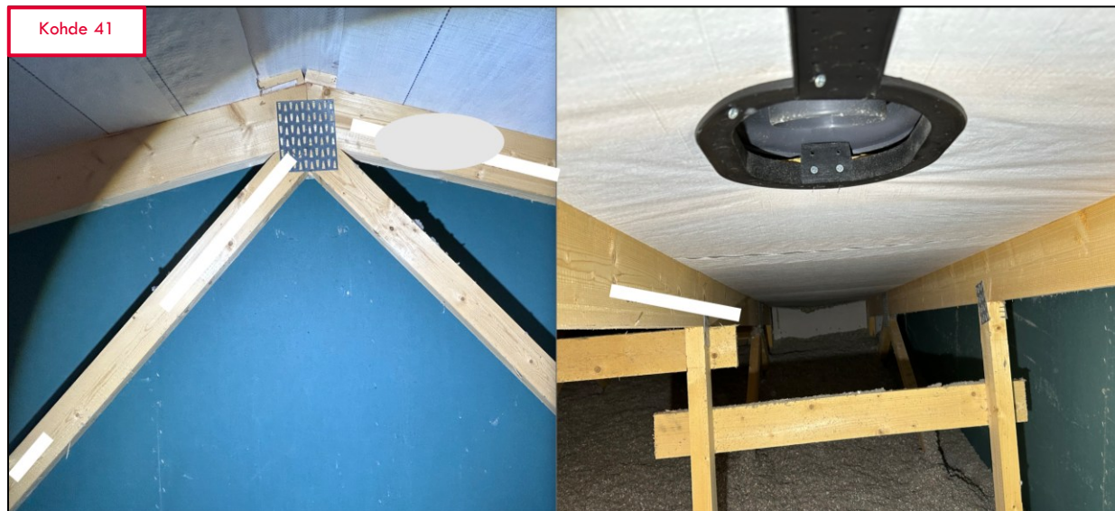
Kuva 96. Harjakattoinen rakennus. Yläpohjan alipainetuuletin ullakolta kuvattuna. Tuulettimia kohteessa molemmiin puolin HVS:stä seinää. Aluskate leikattu harjalta auki ja limitetty, jolloin peltikatteen ja aluskatteen väli tuuletuu hyvin. Rv=2015. Valokuvat: J-P Laakso / SPPL.
