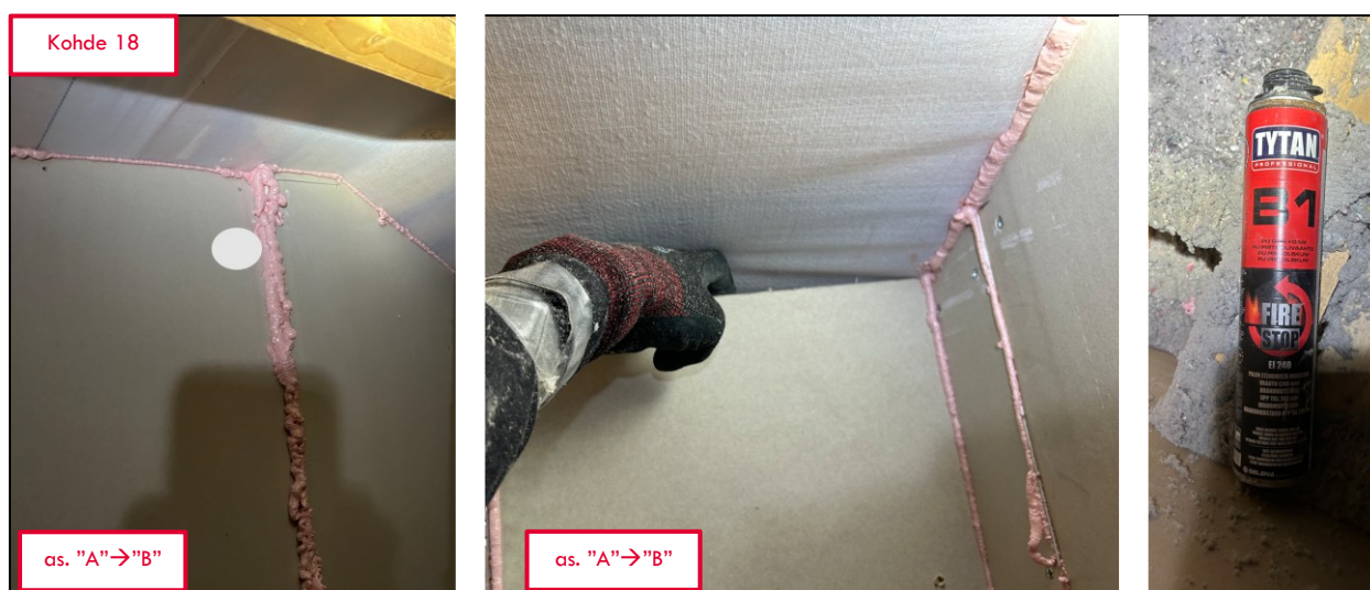
Kuva 90. PU-tiivistysvaahdolla tiivistetty levysaumoja sekä P-O levytystä US:n linjalla. P-O levytyksen ja VK:n välissä havaittiin rako. Yläpohjassa havaittiin purkki, jonka perusteella käytetty vahto on ETA-16/0040. Rv=2021. Valokuvat: J-P Laakso / SPPL.
