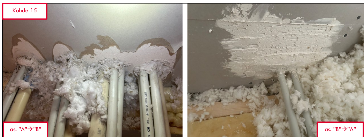
Kuva 81. Kaapeliläpivienti HVS:n läpi, joka tiivistetty mahdollisesti palokatkomassalla. Palokatkosuunnitelmaa ei ollut käytettävissä ja läpiviennin lähetyvillä ei havaittu asennustarvaa tms. merkintää palokatkotuotteesta ja asentajasta. Rv=2017. Valokuvat: J-P Laakso / SPPL.
