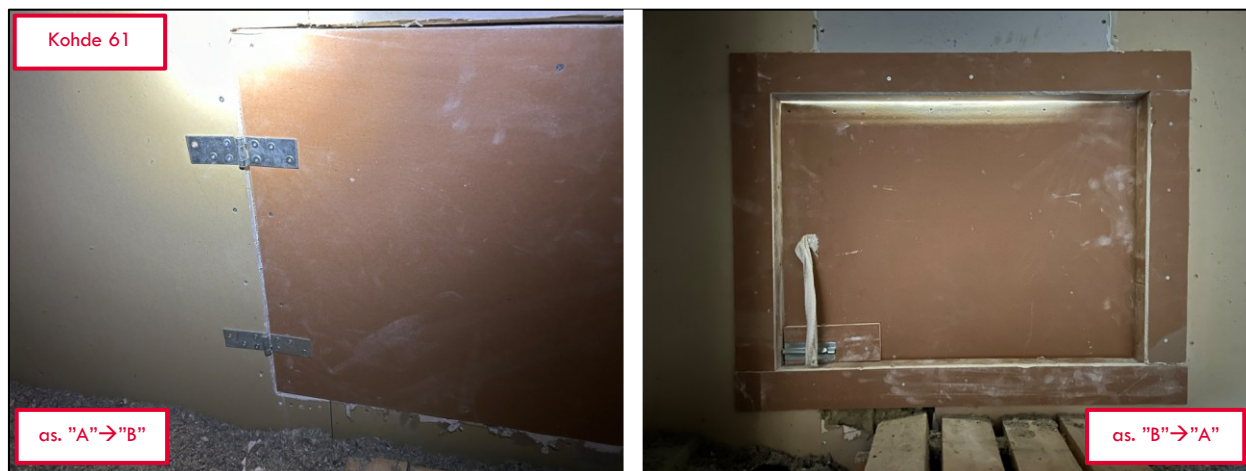
Kuva 71. Rakennuspaikalla tehty luukku palo-osastoivan seinän läpi, jossa saumoissa havaitaan epätiiveyttä. Valo loistaa saumojen läpi. Yksi luukku rakennuksessa havaittiin avoimena käynnin aikana. Rv=2010. Valokuvat: J-P Laakso / SPPL.
