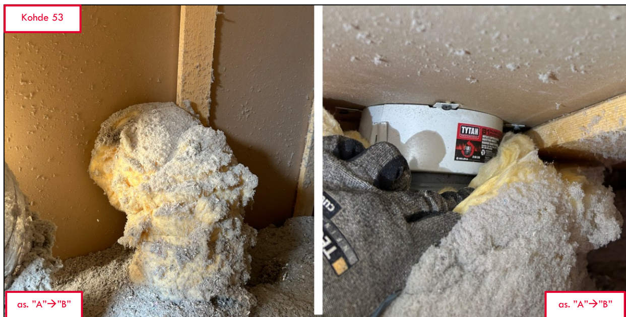
Kuva 80. LVI-läpivienti, jossa palomansetti viemäriputken ympärillä. ETA 15/0035 mukainen tuote. ETA:n keskeiset reunaehdot seinälle: paksuus min. 100 mm, 2*13 mm kipsilevyseinä molemmin puolin rakennetta (ei nähtävissä), paloakryyliitiivistys (ei nähtävissä) ja kannakointi 350 mm seinästä. Rakennesuunnitelmaa ullakon HVS:stä ei ollut käytettävissä. Rv=2017. Valokuvat: J-P Laakso / SPPL.
