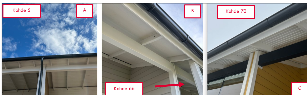
Kuva 62. Kuvassa A terassin kattokannattajien väli suljettu, jolloin palokaasujen kiertämistä terassilta toiselle on hidas-tettu/estetty. Kuvassa B ja C vastaavaa rakennetta ei ole toteutettu. Kuvan B kohteeseen lasitus (punainen nuoli) on asennettu toiselle terassille. Kyseisissä rakennuksissa terassin väliseinä ulotettu kattopohjaan. Rv=2021 (5), 2022 (66) ja 2020 (70). Valokuvat: J-P Laakso / SPPL.
