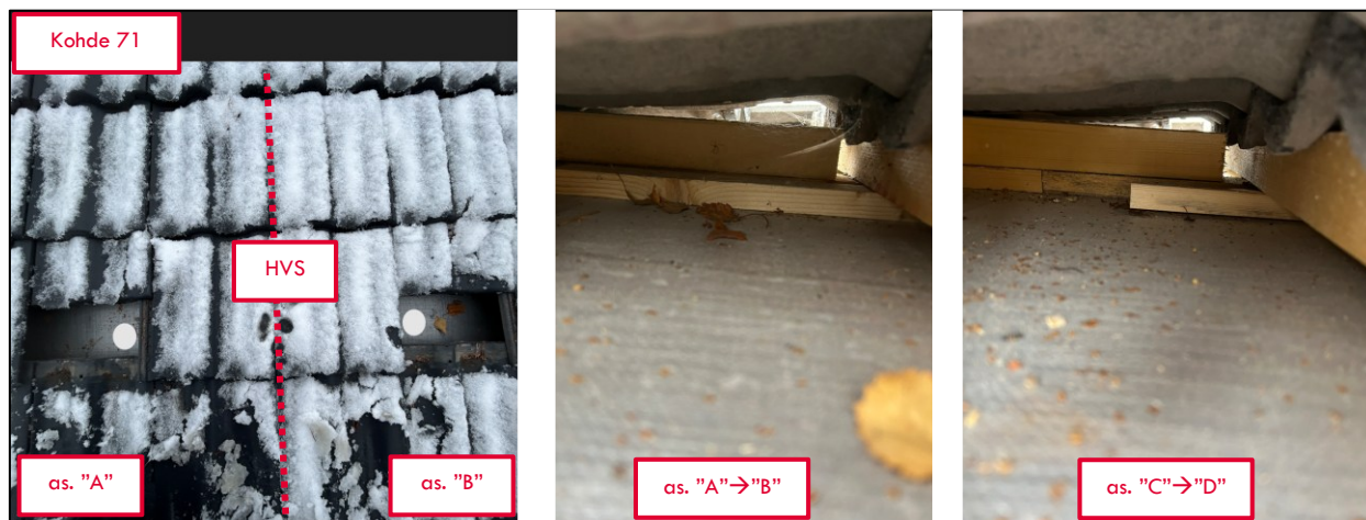
Kuva 50. Ruuteiden välin kapulointia kuvattuna AKV:n ja tiilikatteen välistä. Kapulointi ei luonnollisesti tiivisty tiilikatteen alapintaan. Palokaasuille on rakojen kautta kiertoreitti palo-osastojen välillä. Rv=2020. Valokuvat: J-P Laakso / SPPL.
