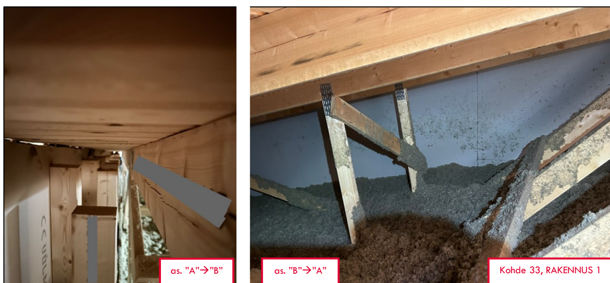
Kuva 28. HVS-VK liitos, jossa raakaponttilaudoitus kattopohjana. Liitos ei vastaa rakennesuunnitelmaa. Liitos vesikatkon ja osastoivan seinän välillä käytännössä tekemättä. Yhtiön toisen rakennuksen toteutus vastaa rakennesuunnitelmaa. Rv=2018/2019. Valokuvat: J-P Laakso / SPPL.
