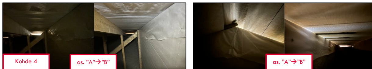
Kuva 23. HVS:n lappeat, joista toisella lappeella tiivistys ruoteiden välissä. HVS:n vastapuolella työvalo, jolla havaitaan, ettei toisella lappeella ole tiivistystä. Harjalla havaitaan tiivistysvillaa. Rv=2022. Valokuvat: J-P Laakso / SPPL.
