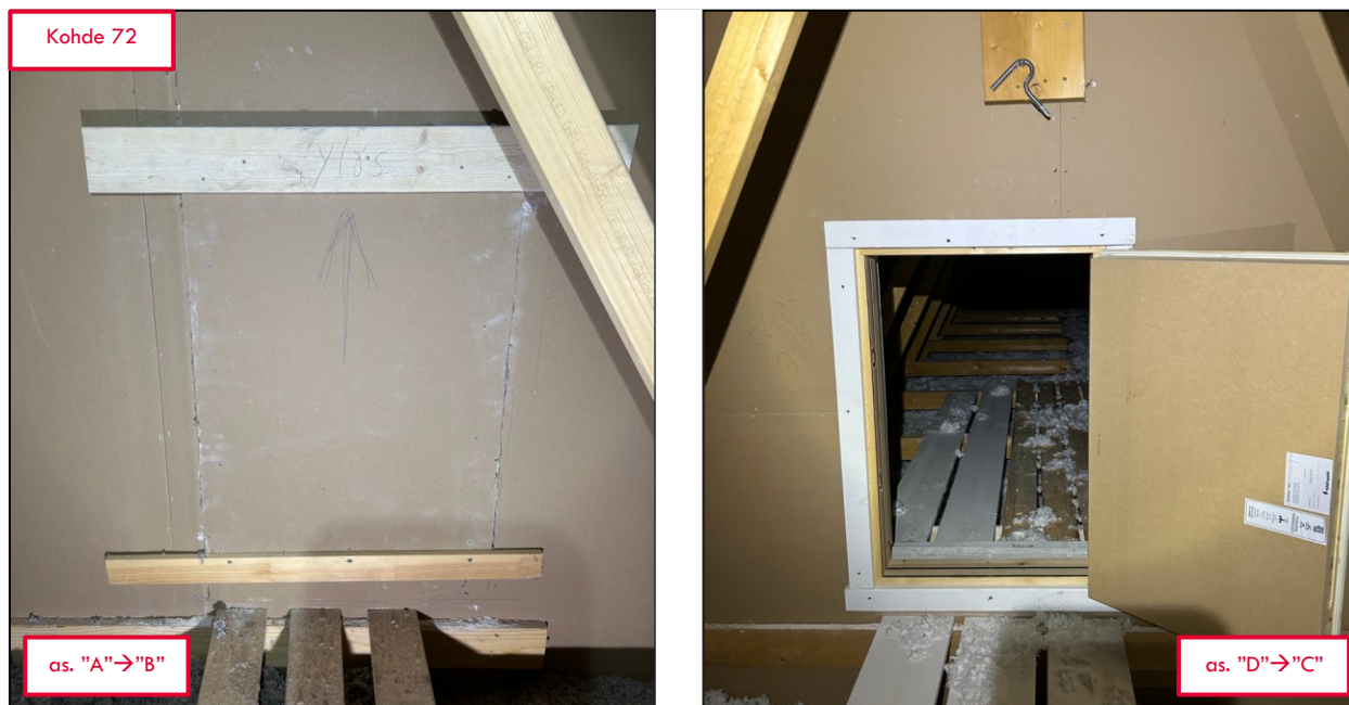
Kuva 67. Tehdasvalmisteinen- ja rakennuspaikalle tehty luukku. Tehdasvalmisteinen asennettu valmistajan ohjeen mukaan. Paikalla tehtyä luukkua ei ole kiinnitetty (ruuvi, telki tmv.), jolloin palopaine (savukaasujen lieskahdus) puskee luukun auki. Kuvat samasta taloyhtiöstä. Rv=2020. Valokuvat: J-P Laakso / SPPL.
