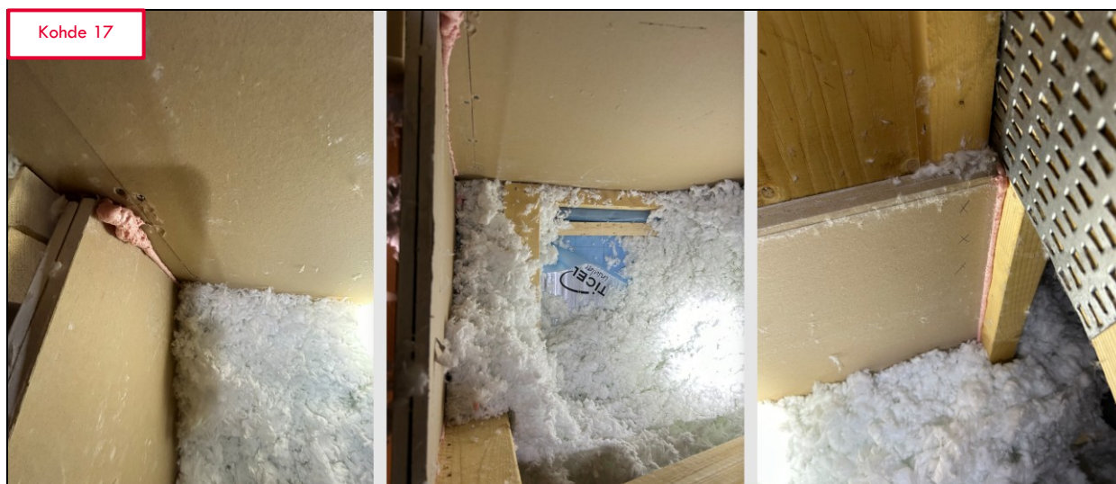
Kuva 93. Palo-osastoiva ulkoseinän suuntainen (P-O) levytys kipsilevy on puskulla HVS:än. Levyn T-liitoksen kiinnitys on toteutettu tiivistysvaahdolla. Tiivistysvaahdon tuotemerkki ei selvinnyt käynnillä. Rv=2021. Valokuvat: J-P Laakso / SPPL.
