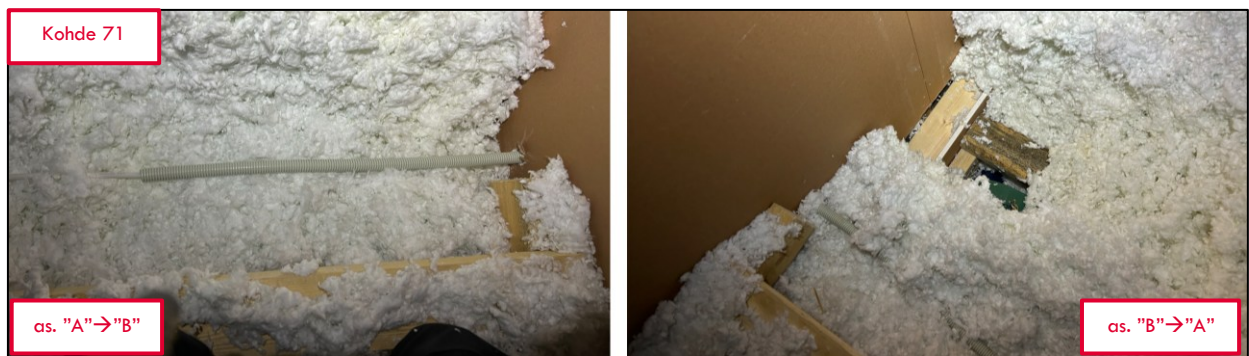
Kuva 83. MMJ-läpivienti suojaputkessa HVS:n läpi puhallusvillakerroksessa. Puhallusvilla ei anna suojaa palotilanteessa, koska sisäkaton palaessa puhki puhallusvillat putoavat asuntoon. Liitosta ei ole tiivistetty. Kuvasta havaitaan että, HVS:n runko jatkuu asunnosta katkeamattomana. Rv=2020. Valokuvat: J-P Laakso / SPPL.
