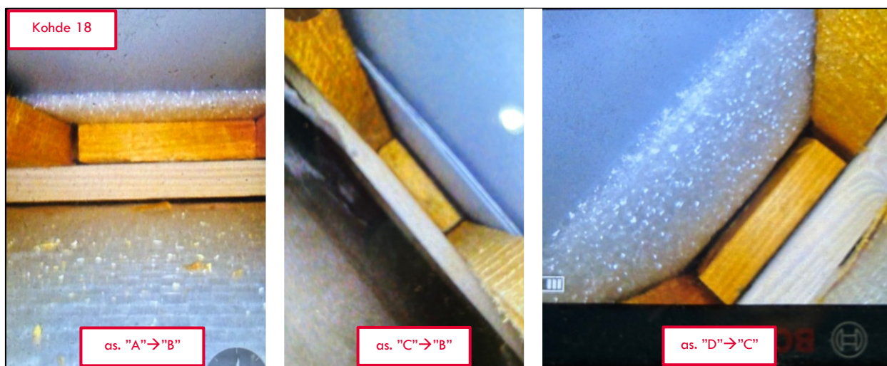
Kuva 48. Kuitukameralla kuvattuna ruuteiden välin kapulointia. Kapuloinnissa on havaittavia rakoja. Peltikatteen äänieristenauha (muovia, palava materiaali) havaitaan HVS:n kohdalla kuvissa A→B ja . Rv=2021. Valokuvat: J-P Laakso / SPPL.
