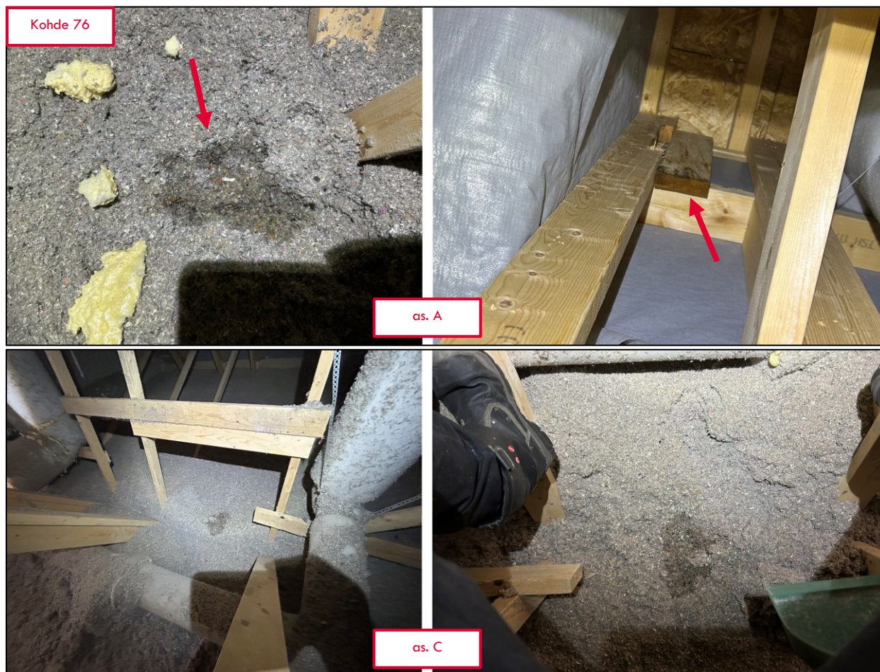
Kuva 95. Tihkuvuoto ullakolla, joka havaittu tarkastuskäynnillä vesisateisena päivänä. Kaikissa asunnoissa vastaavassa kohtaa havaittiin tihkuvuoto (nuoli) piipun kohdilla. Lankun pää on kostea yläkuvassa (nuoli). Rv=2017. Valokuvat: J-P Laakso / SPPL.
