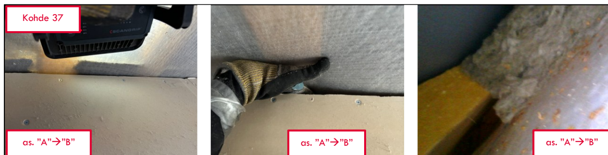
Kuva 41. Peltikatteellisen rakennuksen HVS:n ja VK:n liitos. Ruuteiden välissä havaitaan villatiivistys. Ruuteen ja HVS:n välissä havaitaan epäjatkuvuuskohta tiivistyksessä. Rakennesuunnitelmassa tiivistysvilla on esitetty kahtena kerroksena, jolloin ruuteiden alaosaa tulee tiivistettyä. Toteutus ei vastaa suunnitelmaa eikä TOPTEN-palokortin periaatetta. Rv=2018. Valokuvat: J-P Laakso / SPPL.
