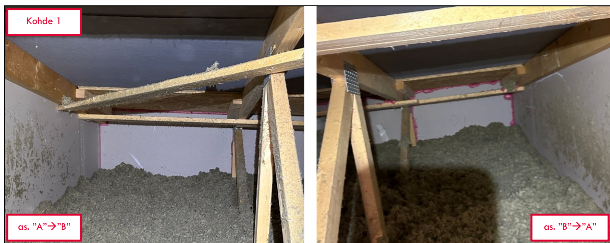
Kuva 85. PU-tiivistysvaahdolla tiivistetty luhtikäytävän suuntaista osastoivaa seinää. Rakenneleikkauksessa ei ollut mainintaa vaahdon käytöstä. Tiivistysvaahdon tuotemerkki ei selvinnyt käynnillä. Rv=2018. Valokuvat: J-P Laakso / SPPL.
