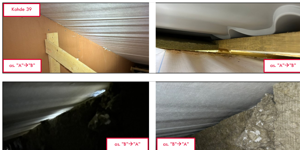
Kuva 44. Profiilipeltikatteellisen (tiilikuviollinen) rakennuksen HVS:n ja VK:n liitos. Ruoteiden väliin asennettu kovavillapalat. Kovavilla ei tiivisty aaltokuvioillisen pellin alapintaan. Valo havaitaan loistavan seinän ”yli”. Rakennesuunnitelmassa esitetty ”mineraalivillakaistat n. 400 mm leveydelle”. Liitoksella ei ole joustovaraa, koska AKV:n päällä on tuuletusrimat HVS:n kohdalla. Asunnon ”B” ullakolla poikkeuksellinen ratkaisu, jossa HVS eristettykipsilevyseinän ulkopuolelle. Rv=2015. Valokuvat: J-P Laakso / SPPL.
