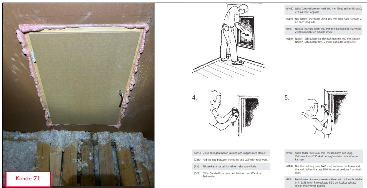
Kuva 69. Kuvassa tehdasvalmisteinen (paloluokiteltu) luukku, joka tiivistetty paisuvalla tiivistysvaahdolla. Luukun asennusohjeen (kuvassa oikealla) mukaan tiivistys tulee tehdä vuorivillalla. Lisäksi EI30-luokassa saumat tulee liittää molemmin puolin luukkua. (35) Rv=2020. Valokuva: J-P Laakso / SPPL.
