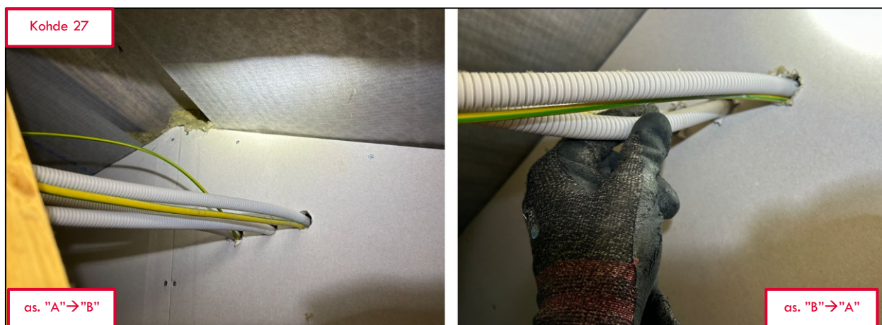
Kuva 79. Sähköläpivienti HVS:n harjan lähellä. Liitosta ei ole tiivistetty. Rv=2015. Valokuvat: J-P Laakso / SPPL.
