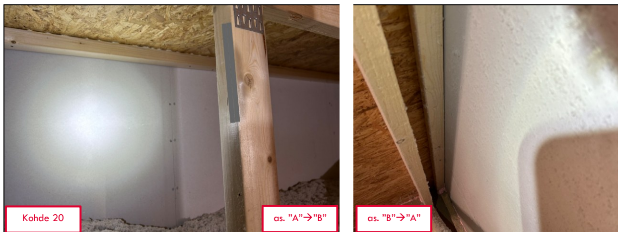
Kuva 24. HVS-VK liitos, jossa OSB-levy kattopohjana. Liitos vastaa rakennesuunnitelmaa pl. nurkan "palo"uretaanitiivistys. Tietoa aineesta tai -soveltuvuudesta puu/kipsilevy-puu-liitoksen tiivistyksen ei ollut käytössä. Rv=2023. Valokuvat: J-P Laakso / SPPL.
