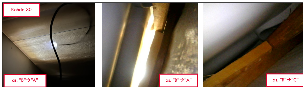
Kuva 43. Profiilipeltikatteellisen (tiilikuviollinen) rakennuksen HVS:n ja VK:n liitos. Ruuteiden väli kapuloitu. Aaltomuodosta johtuen liitos ei tiivisty käytännössä. Työvalolla on havainnollistettu tilannetta seinän toiselta puolen (HVS A→B). Rakennesuunnitelmassa liitoksen tiivistys esitetty 400 mm leveällä mineraalivillalla. Liitos ei vastaa rakennesuunnitelmaa. Rv=2017. Valokuvat: J-P Laakso / SPPL.
