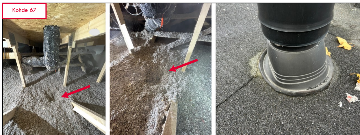
Kuva 94. Vesikatteen IV-läpivienti tihkuttanut selluvillan kuopalle (nuoli) . IV-läpiviennin alta selluvilla havaittiin kovettuneeksi. Tilannetta on yläpuolelta kattoläpiviennistä hankala havaita. Rv=2021. Valokuvat: J-P Laakso / SPPL.
