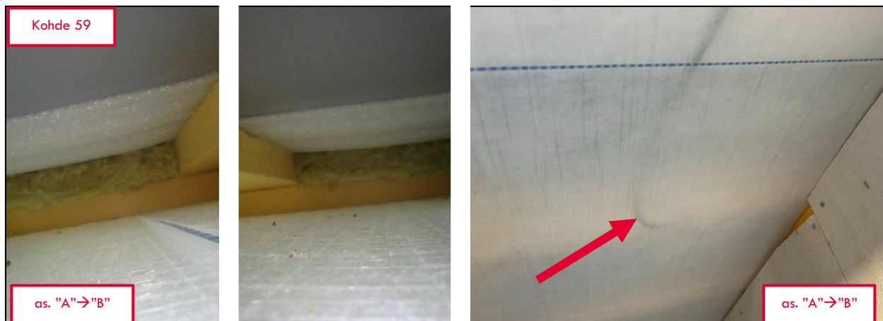
Kuva 40. Peltikatteellisen rakennuksen HVS:n ja VK:n liitos. Rakennesuunnitelmassa on määritelty "palamaton villa" ruoteiden väliin. Villatiivistyksen dimensioita ei ole määritelty. Liitoksella ei ole joustovaraa, koska AKV:n päällä on tuuletusrimat HVS:n kohdalla. HVS tukeutuu valuharkkojen päälle. AKV:n yläpuolelle nähdään kuitukameralla (nuoli). Liitos vastaa rakennesuunnitelmaa muttei TOPTEN-palokortin periaatetta. Rv=2021. Valokuvat: J-P Laakso / SPPL.
