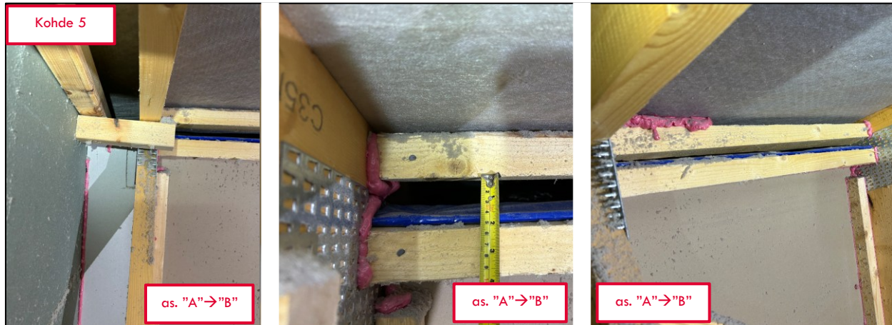
Kuva 86. PU-tiivistysvaahdolla tiivistetty NR-kentän läpi kulkevan P-O linjan levysaumoja. Rakenneleikkauksessa ei ollut mainintaa vaahdon käytöstä. Tiivistysvaahdon tuotemerkki ei selvinnyt käynnillä. Kohteessa käytetty lisäksi paisuvaa palokatkonauhaa tuuletusraossa. Rv=2021. Valokuvat: J-P Laakso / SPPL.
