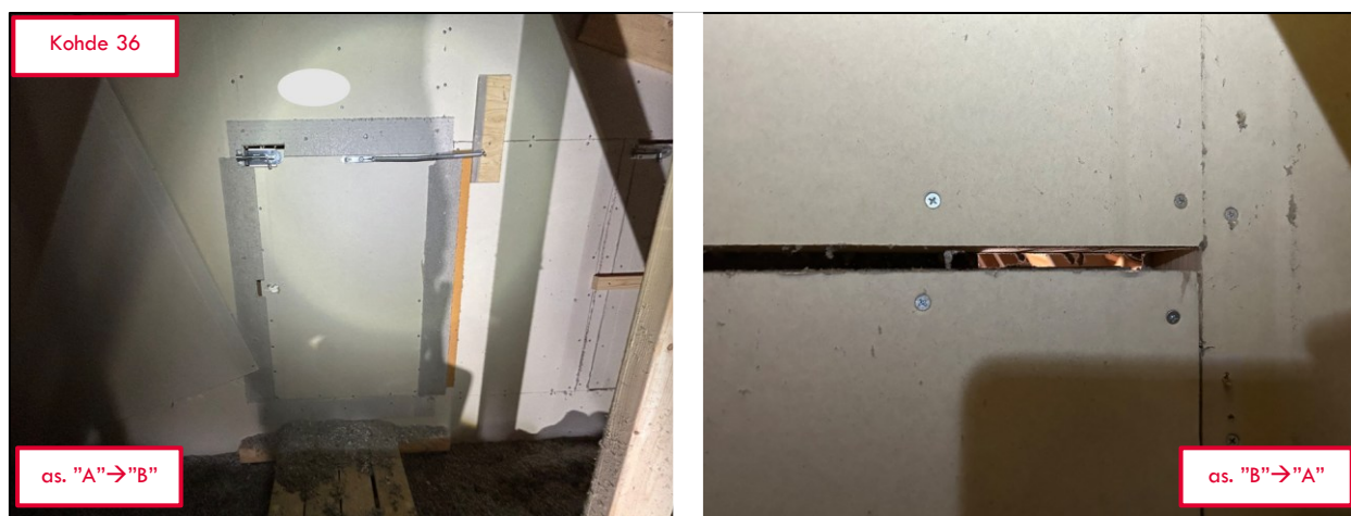
Kuva 70. Rakennuspaikalla tehty luukku palo-osastoivan seinän läpi. Salvan kohdalla havaitaan avoin sauma (kuva oikealla). Kivilevy soiroja asennettu saumoin. Osa soiroista pudonnut kiinnityksestä. Osa luukuista avoimena. Luukku ei salpautu itsestään. Rv=2014. Valokuvat: J-P Laakso / SPPL.
