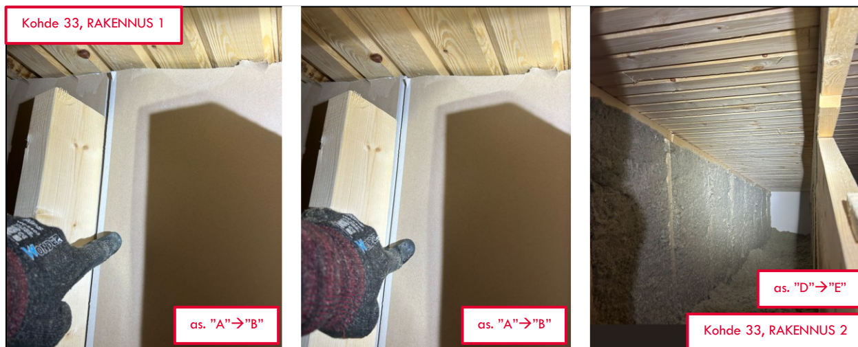
Kuva 29. HVS-VK liitos, jossa raakaponttilaudoitus kattopohjana. Toteutus "D"→"E" vastaa rakennesuunnitelmaa, jossa tuplalevytykset rungossa toispuoleisesti. Vasemmalla puolella havaitaan, että runko ja levytyksen sauma ei koh- taa. Rv=2018/2019. Valokuvat: J-P Laakso / SPPL.
