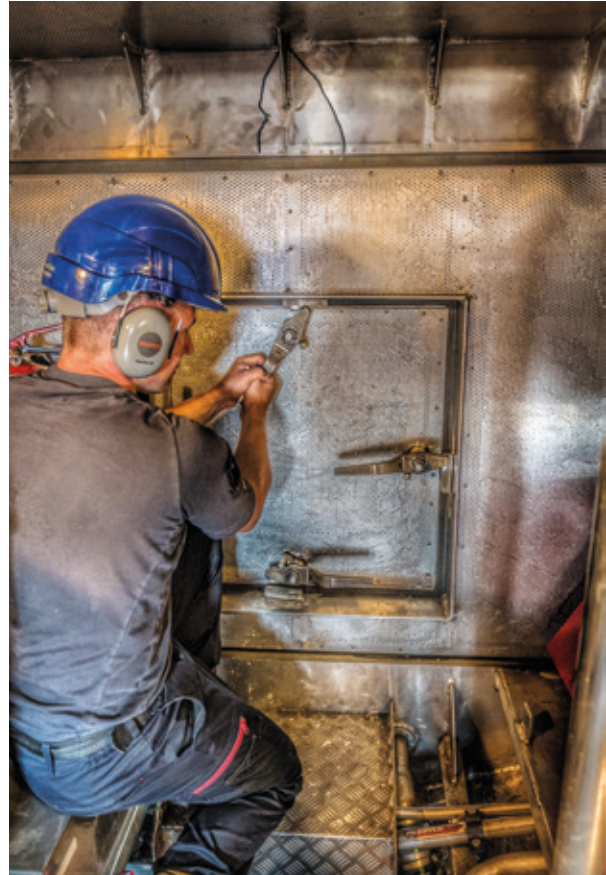
Aluksen vesitiiviiden laipoiden luukut ja ovet pidetään suljettuna aluksen liikkeellä ollessa.
