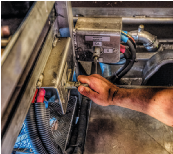
Aluksen virrat kytketään päälle pääkytkimestä. Kytkimiä on usein kolme tai enemmän aluksen järjestelmien laajuudesta riippuen.
